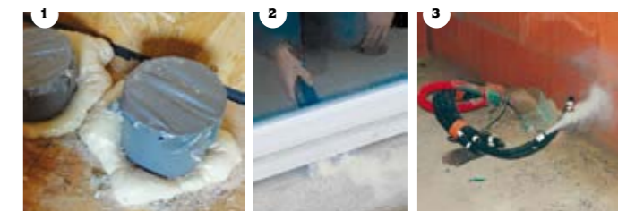
1. Traversées de parois non soignées (© CO2 Conseil) - 2. Installation de coulisants « classiques » (© Air Vision) - 3. Tableau électrique dans volume non chauffé (© Air Vision)
