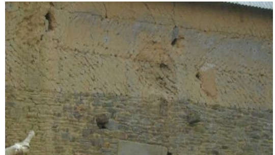
63 Mur en gazon érodé- crédit photo PNR Marais du Cotentin et du Bessin
