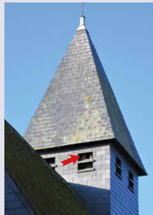
▲ Entrée du nichoir très peu perceptible depuis l'extérieur
