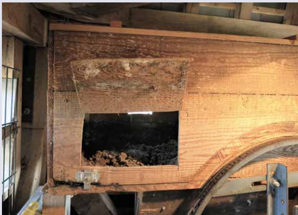
▲ Accès au nichoir pour le nettoyage
